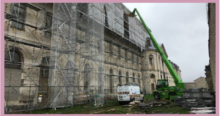
Restauration de la couverture du réfectoire-chapelle de l'abbaye de Clairvaux, oct. 2020 © DRAC Grand Est
