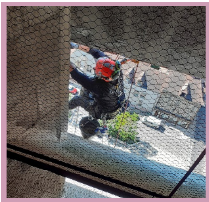
Travaux de mise en sécurité des abat-sons de la Cathédrale de Troyes © DRAC Grand Est
